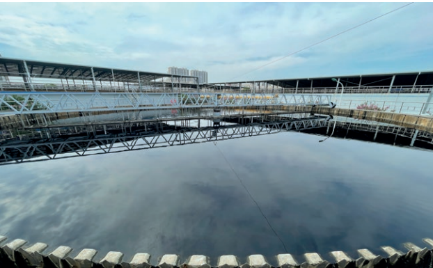
漢川銀龍水務有限公司污水處理廠的出水澄清透亮，水質穩定達標
