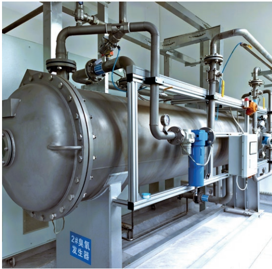
深圳大工業區水務公司水廠二期新建的深度處理工藝設備
