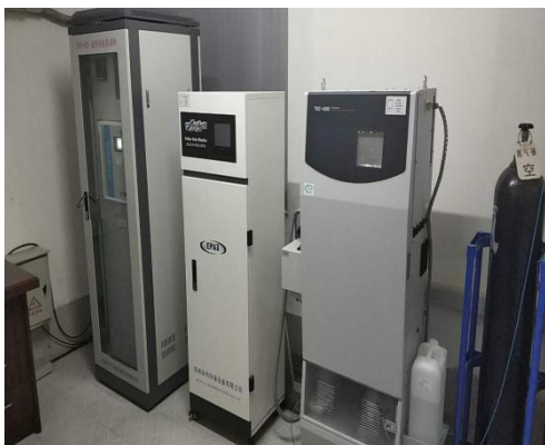
污水总排口在线监控设施
