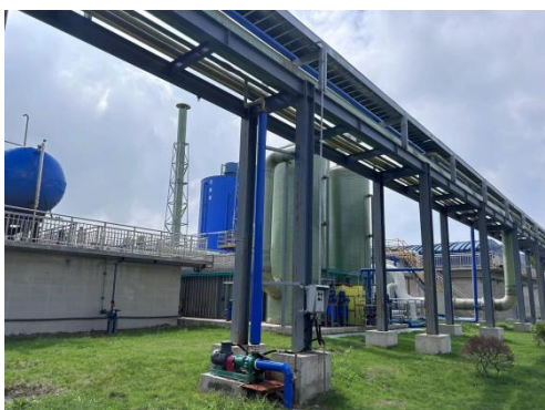
南区污水处理站
