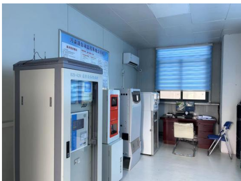
南区废水在线监控设施
