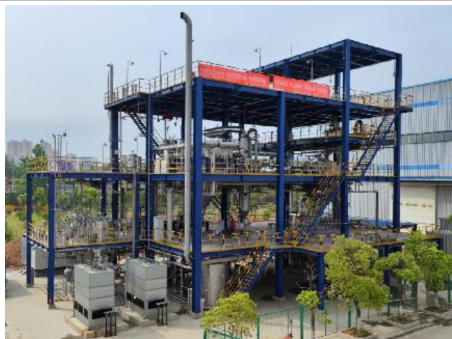
高温焚烧处理试验装置
