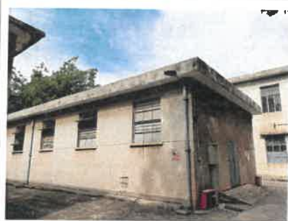
宗地内建筑物
