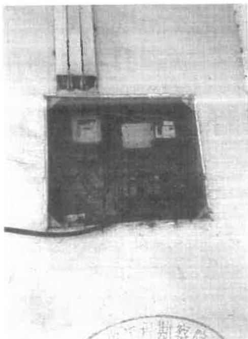
室内独立电表-1照片
