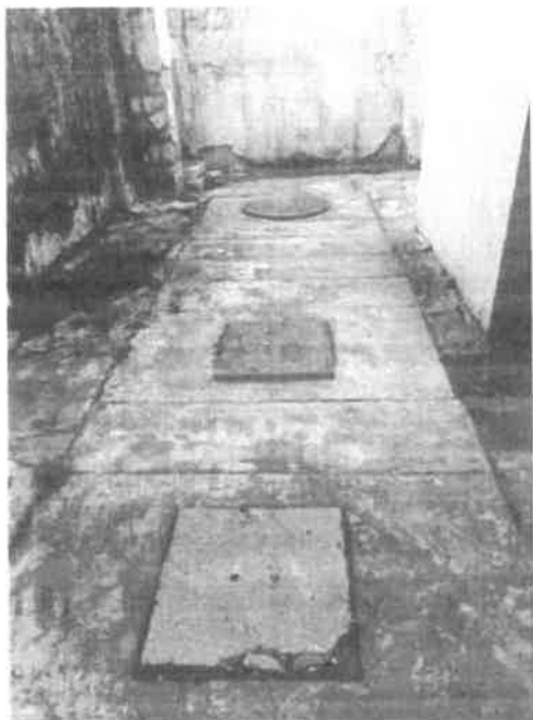
室外独立化粪池-1照片
