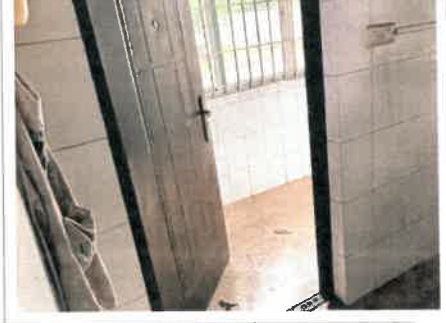
宗地内建筑物
