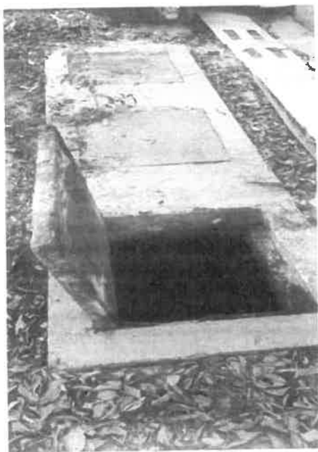
室外独立化粪池照片
