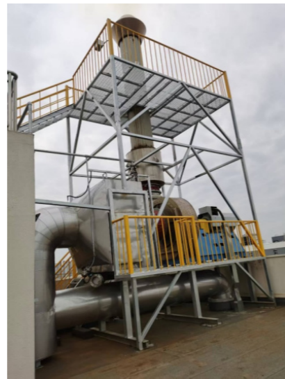
试车尾气处理设备
