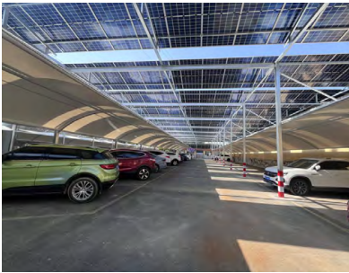
玲珑金矿光伏发电装置
