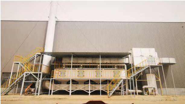
喷漆废气处理设备
