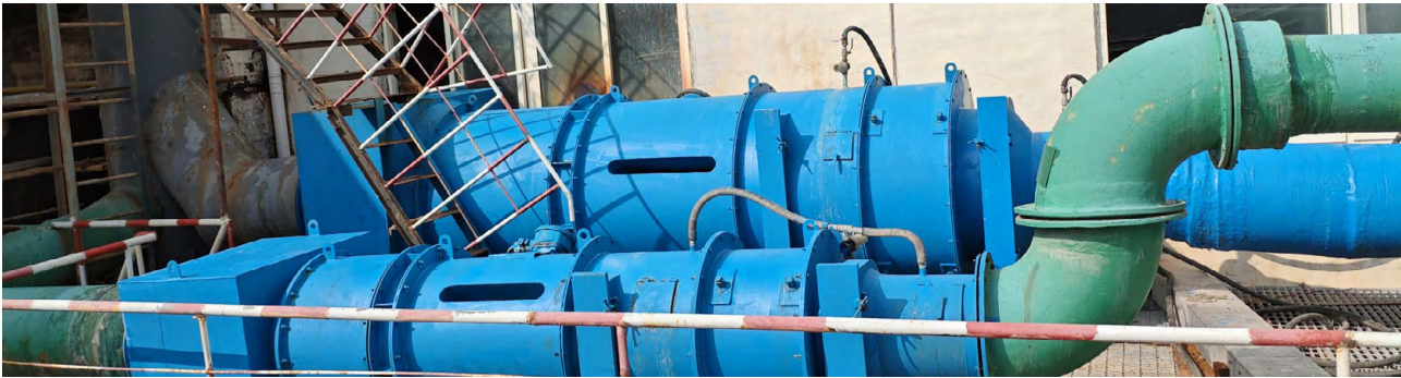
新城金矿破碎除尘系统
