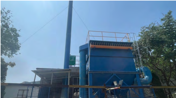
玲珑金矿布袋除尘器
