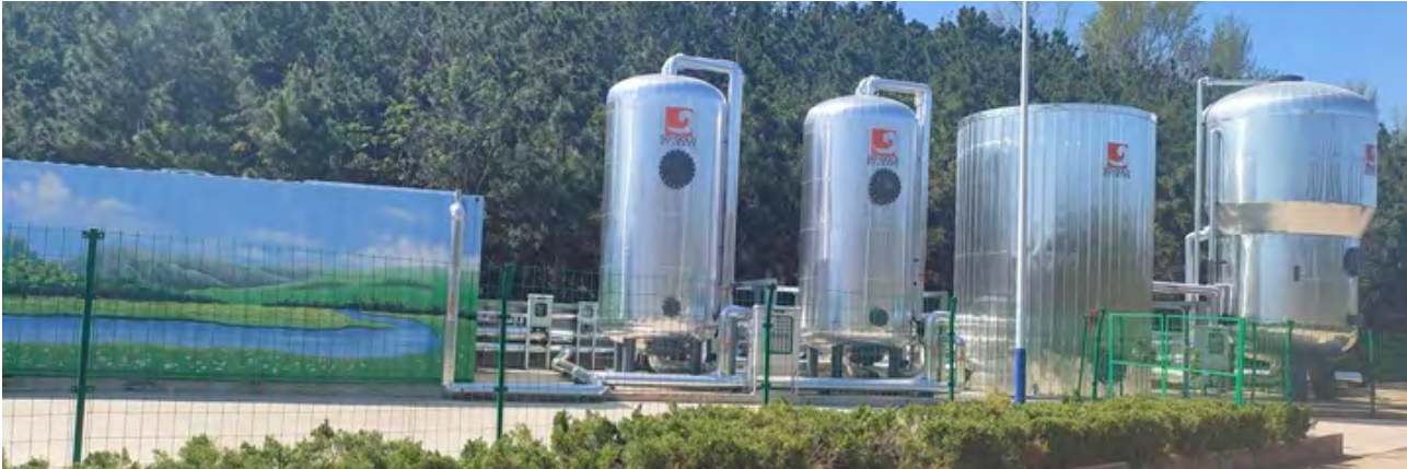
归来庄公司矿井水净化处理工程
