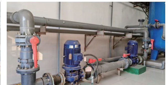
通州公司清水泵输送装置
