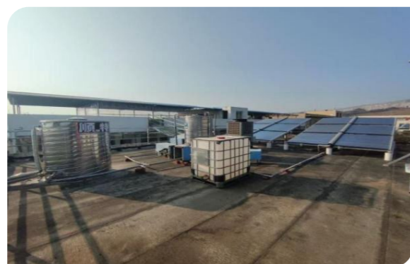
屋顶安装的空气能供暖装置
