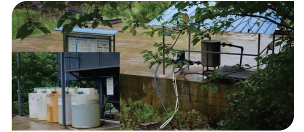
污水处理系统
