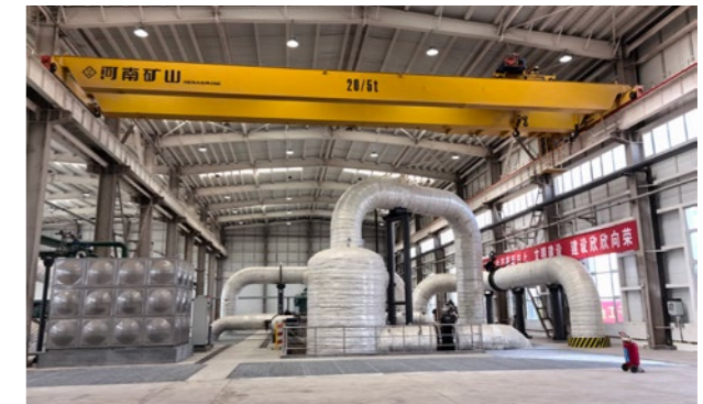
托克托电厂至呼和浩特市市长输供热管网工程管道
