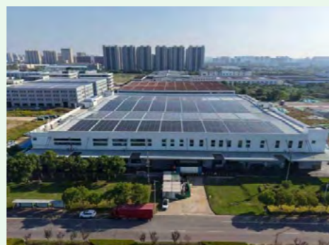
南京公司光伏设备图片
