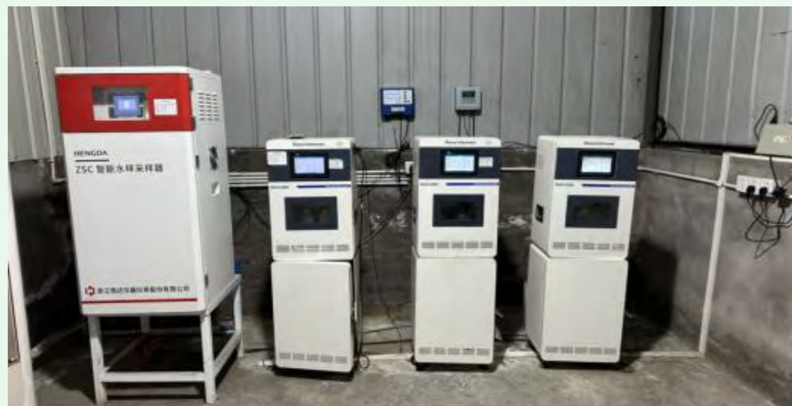
废水污染物排放在线检测系统
