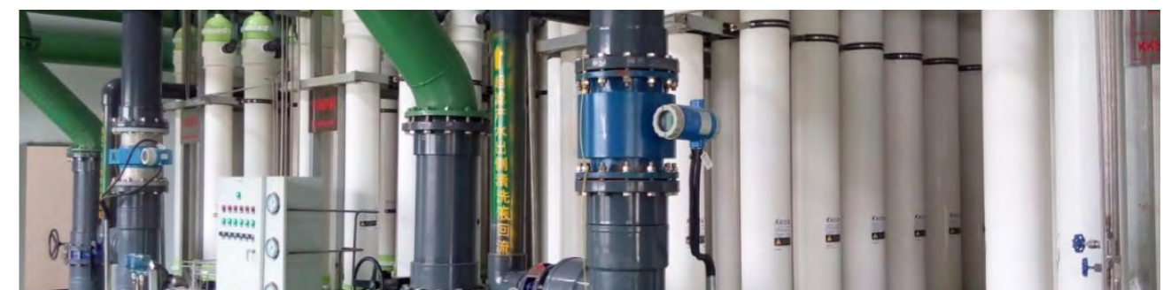
湛江电力公司中水回用系统
