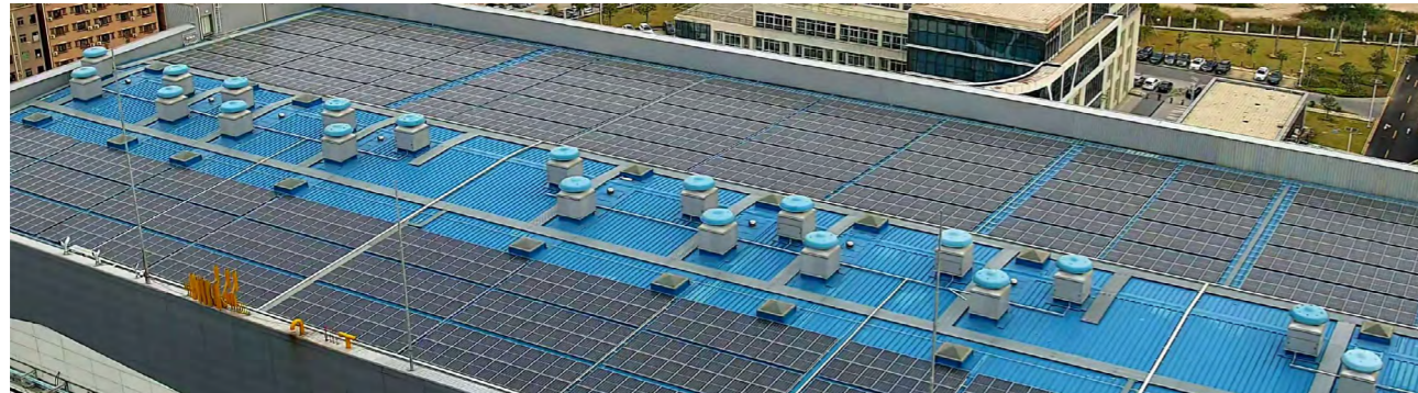
滨海湾公司屋顶光伏
