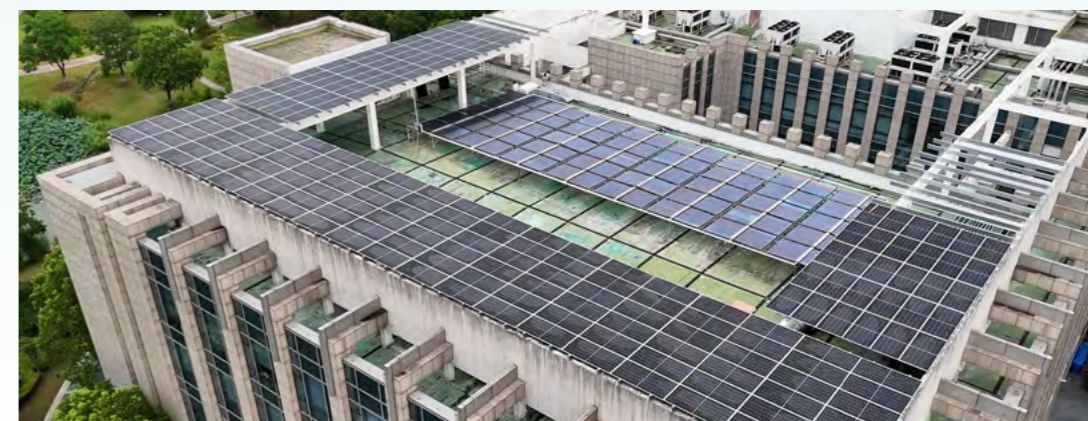
江苏省分行方山园区屋面光伏组件阵列。
