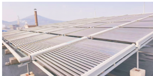
太阳能供热系统
