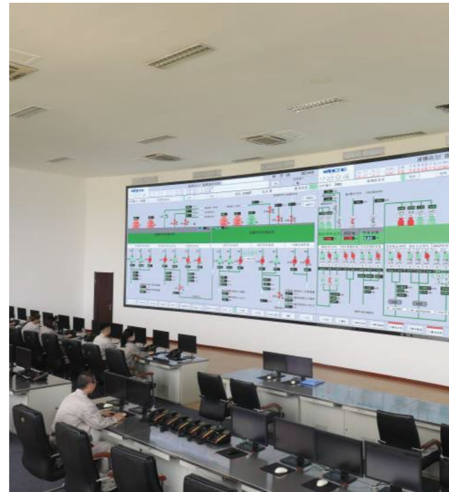
能源管控中心
