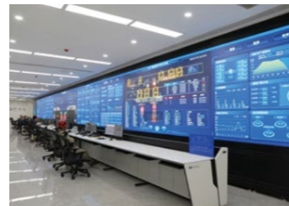
钢轧厂炼钢集控中心
