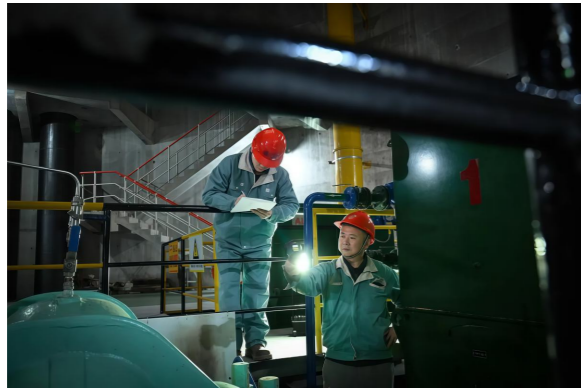
春节期间工作人员检查水泵
