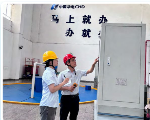
国庆中秋期间生产现场运行设备巡检
