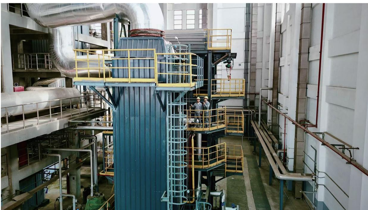
郑州新区污水处理厂热解气化项目运行现场
