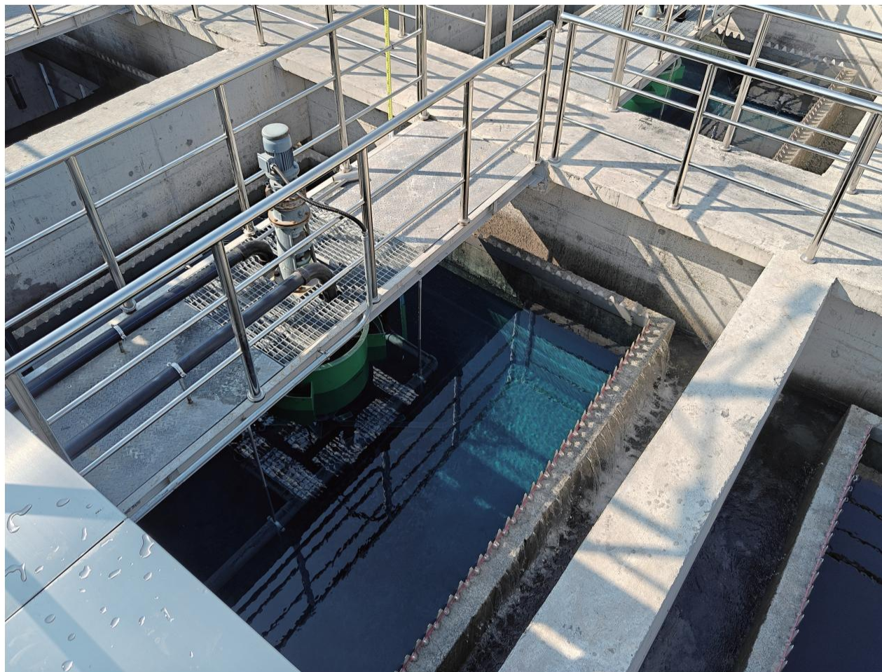
郑州新区污水处理厂活性焦工艺运行廊道
