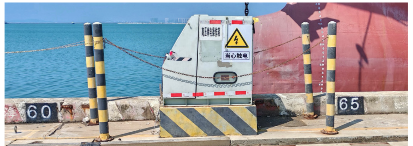
汕头港高压岸电设备
