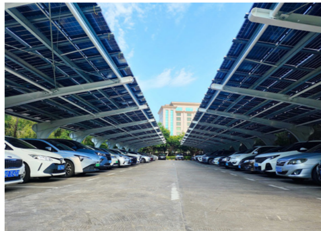
汕头港采用建筑光伏一体化（BIPV）形式建设光伏车棚
