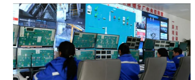
扎布耶二期工厂中央控制室
