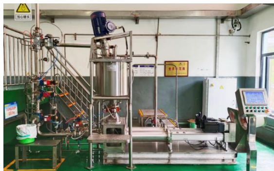
（JWL-GT 型无固定操作人员乳化炸药生产工艺及设备）
