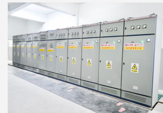
能源系统高低压配电柜
