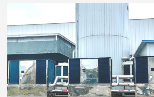
太阳谷屠宰厂空气源热泵机组
