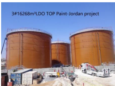
约旦侯赛因电站项目油罐
