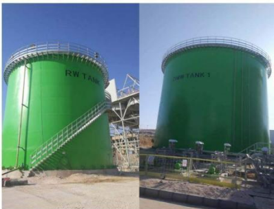
约旦侯赛因电站项目除盐水罐
