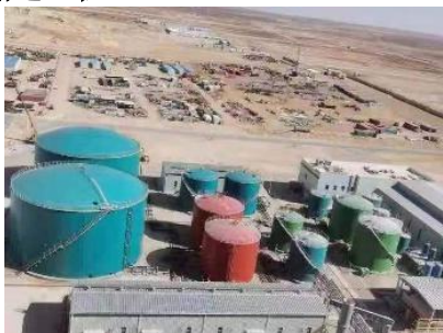
约旦阿特拉特页岩电站项目储罐群
