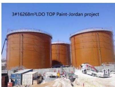
约旦侯赛因电站项目油罐
