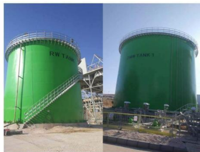
约旦侯赛因电站项目除盐水箱
