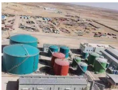
约旦阿特拉特页岩电站项目储罐群
