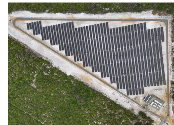
竣工光储电站全景
