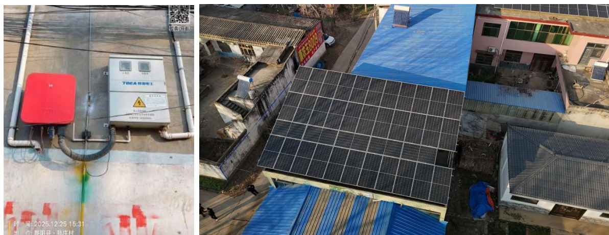
图 2 逆变器及光伏电站资产
