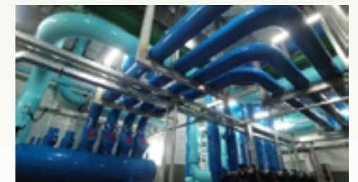
一建智慧运维平台
