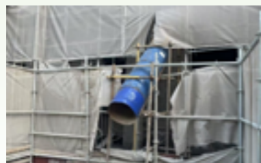
高效清运，模块化垃圾通道系统
