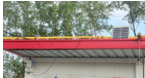
施工生活区绿色能源利用
