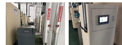
盐城立铠空压机余热回收
