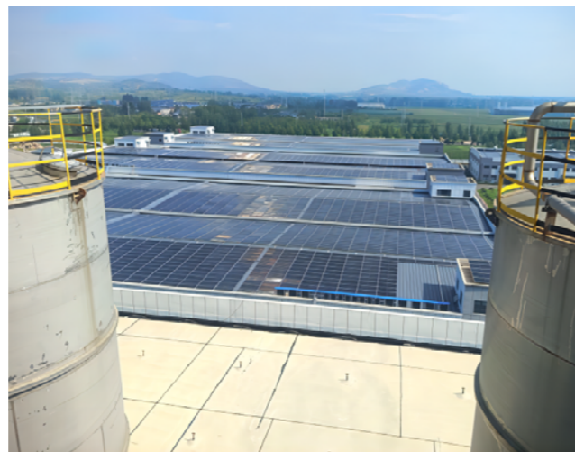
● 聚合顺光伏发电设备
