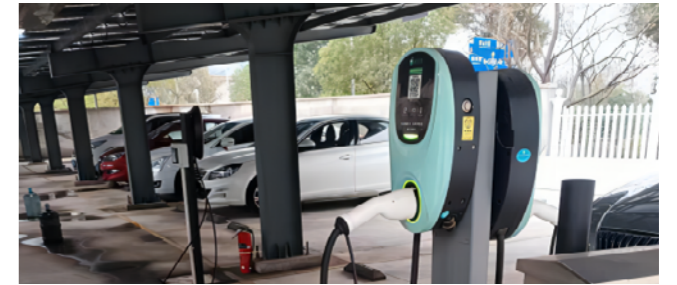
● 公司新能源充电桩
