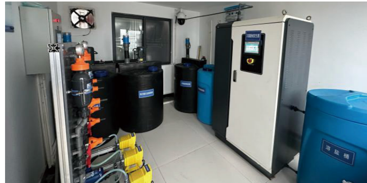
精准加药控制室
