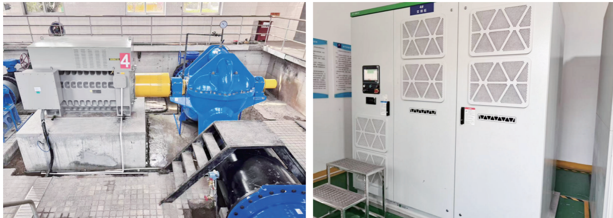
变频水泵机组
