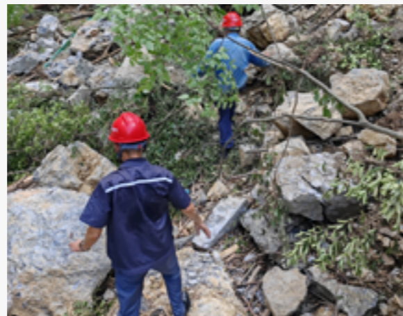
长南公司员工在现场塌方处检查燃气管道受损情况
