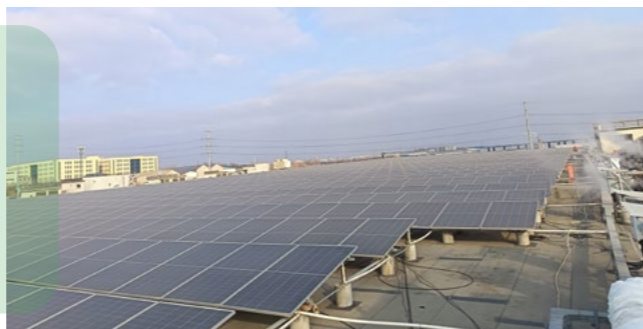
各园区光伏发电
