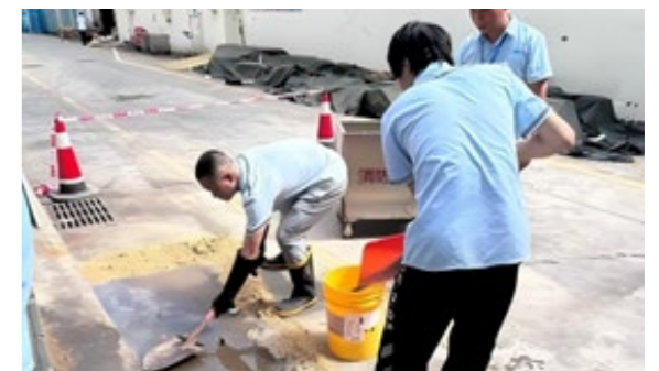
收集泄漏废水
