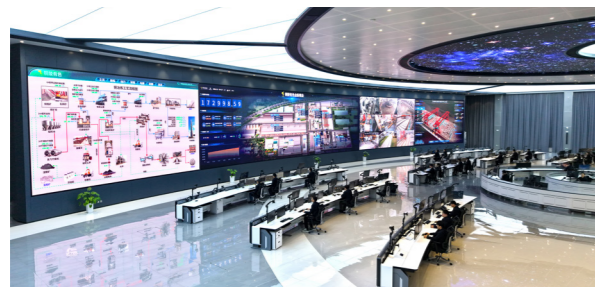
金新铜业分公司智慧控制大厅
