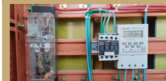
现场照明设置定时器
