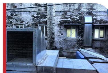
食堂安装除油除尘装置,定期清理排烟系统
