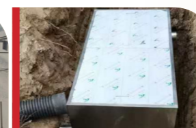
厨房设置隔油池
