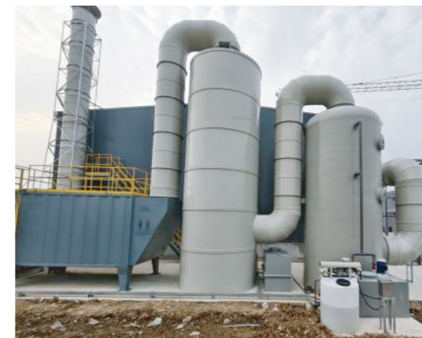
刚性填埋场除臭项目
