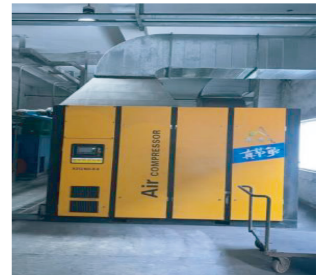
空压机节能改造项目
