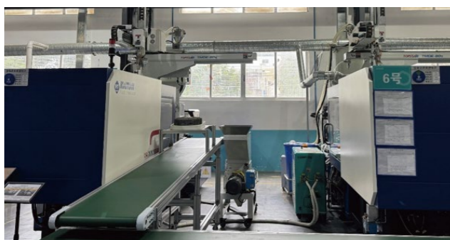
注塑车间完成模温机技术升级改造,实现一机带双机运行模式,降低系统能耗。
