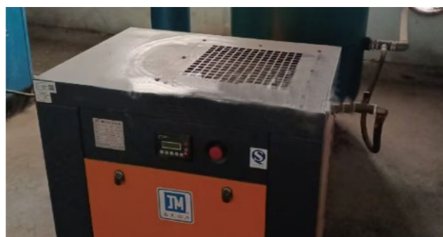
注塑车间实施空压机功率优化改造,夜班改用小功率空压机独立供气,大幅减少空耗与能源浪费。
