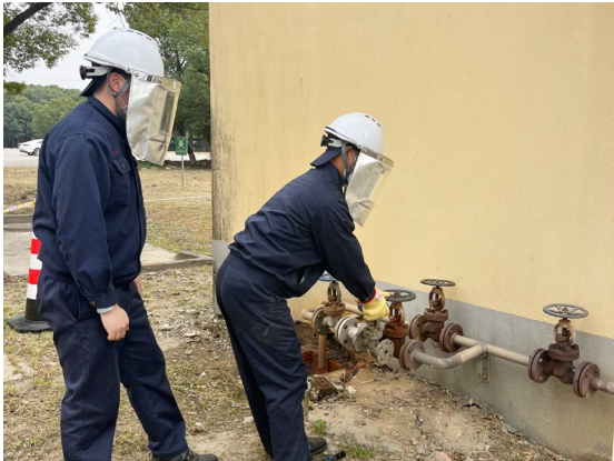
蒸汽管道泄漏事故应急演练
