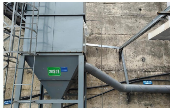
废气处理设施
