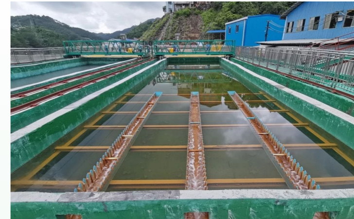
废水深度处理站
