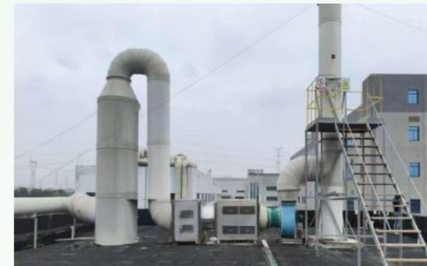
国瑞药业改造后的危险废物库废气治理设施
