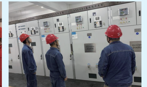
电气设备运行检查
