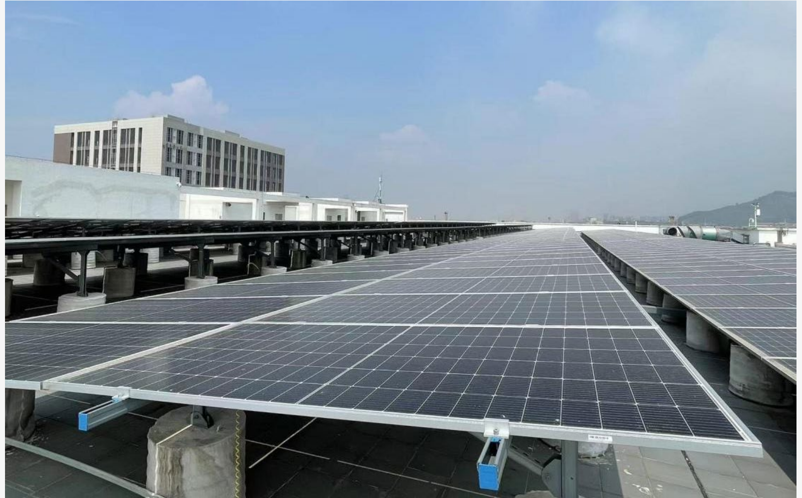
启润仓库光伏板
