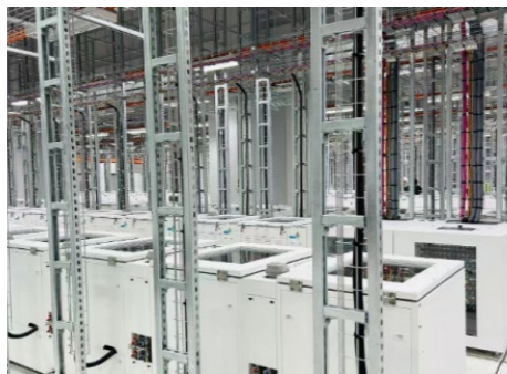
马来西亚某数据中心浸没液冷系统
