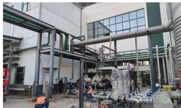
新开源制药实施 102 车间冷冻机系统节能改造
