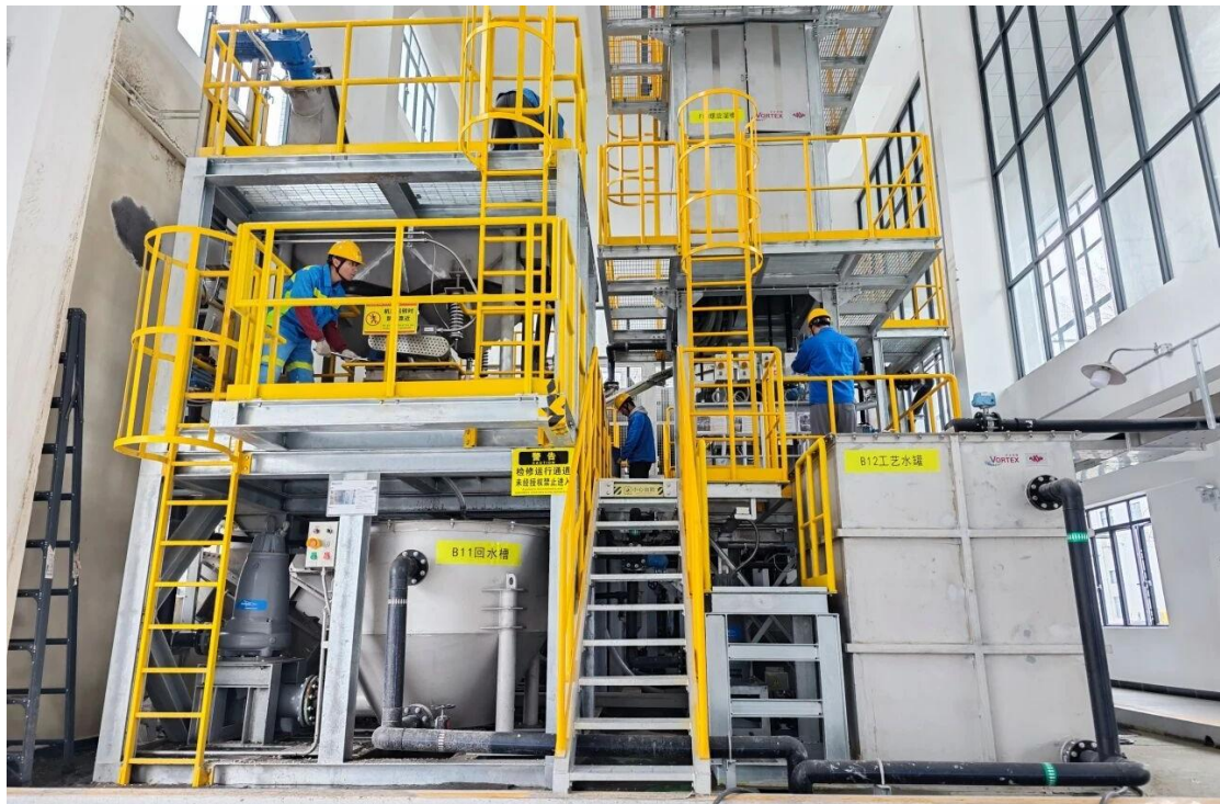
瀚蓝通沟污泥项目生产设备
