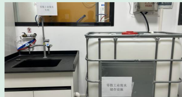
零散工业废水储存设施
