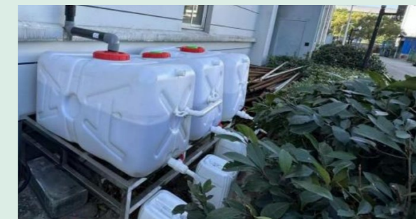
创蓝检测废水处理装置
