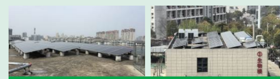
安徽宇测厂房楼顶光伏发电板
