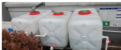
创蓝检测废水处理装置
