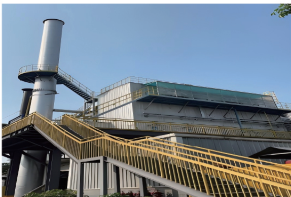
RTO焚烧系统
