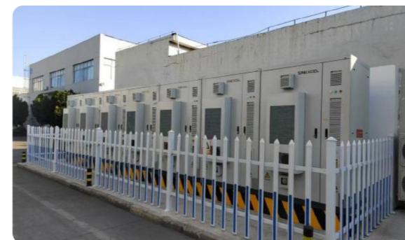
长街工厂 2.3 兆瓦 / 4.6 兆瓦时储能项目
