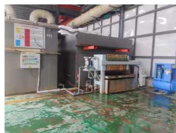
“四新”技术污水处理系统
