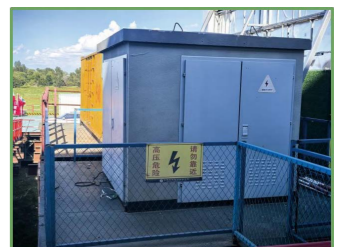
配电箱封闭式吸音屏障
