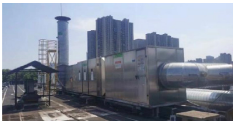
废气处理设备设施
