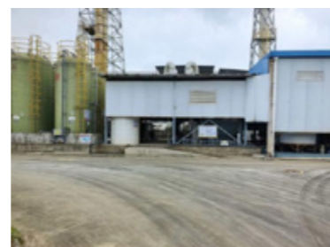
废水处理设备设施
